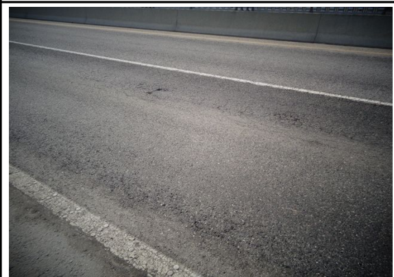
S15 망상균열 및 소성변형 (양평방향)
