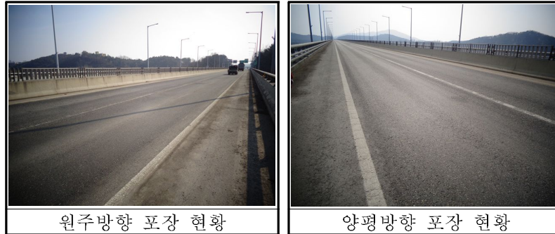
【그림 3.3】 교면포장 현황
