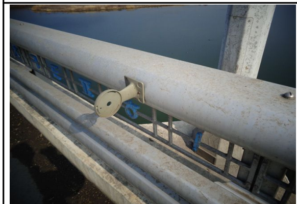
S23 텔리네이터 파손 (양평방향)
