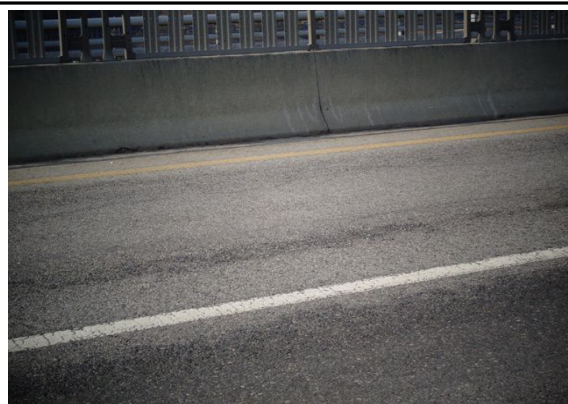
S9 아스콘 균열 (양평방향)
