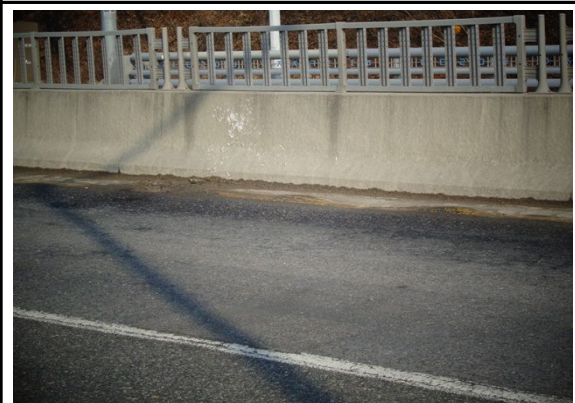
S32 망상균열 및 소성변형 (원주방향)
